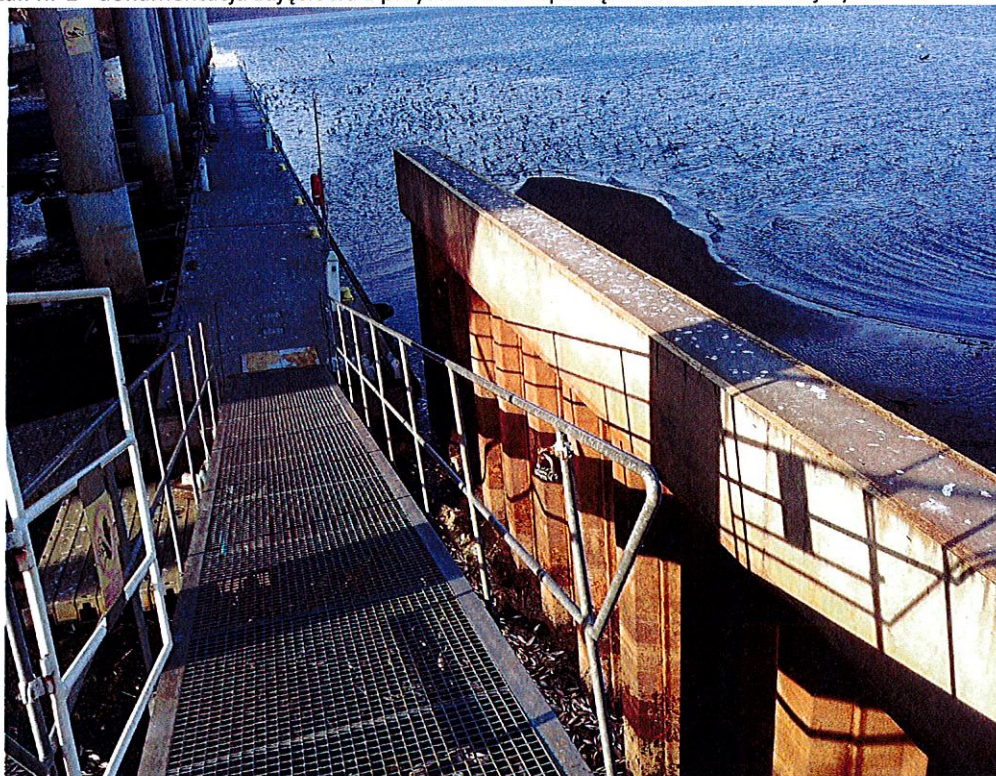
Załącznik nr 1 – dokumentacja zdjęciowa z przystani OSIR sporządzona w dniu dzisiejszym.
